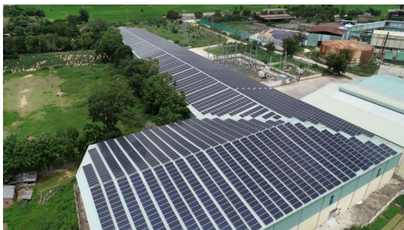
Hệ thống điện mặt trời áp mái của SBT tại TTC Gia Lai
